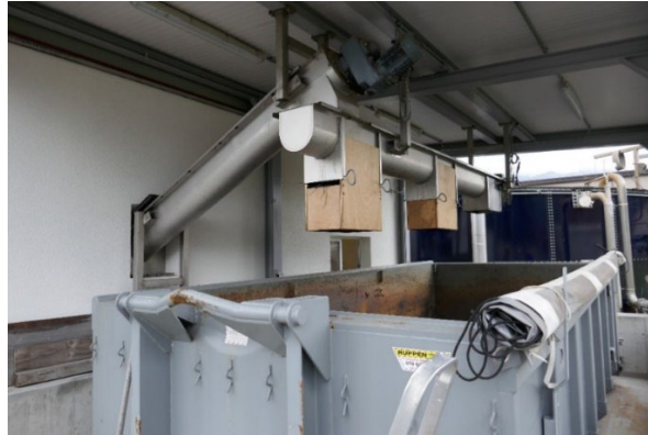
Figure 35 : Exemple de vis de répartition des boues dans la benne
